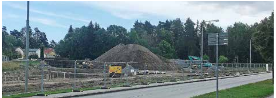
Svenska Bostäder har lämnat in ansökan om ändringar i bygglovet för de "snabba husen" – trots att grundarbetena redan har kommit långt. Bakom inhägnaden vid Räckstavägen kan man se en jättelik sandhög. Man har redan grävt för grunden och lagt ner vatten- och avloppsrör med mera.
